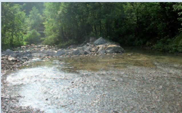
Nella fotografia si nota la soglia realizzata in modo da non impedire la libera migrazione dei pesci e che, nello stesso tempo, permette all'acqua di estendersi su un'ampia area al di sotto della quale sono stati posati i tubi-filtro che captano l'acqua che dall'alveo si infila nel sottosuolo.
