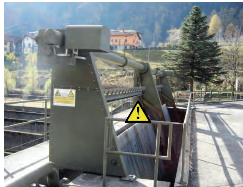
Fig. 7 - Presenza di strutture mobili, la cui messa in funzione è automatica e può avvenire in qualsiasi momento senza alcun preavviso schiacciando, colpendo o facendo cadere chi sosta nei pressi oppure causare ondate che travolgono chi sosta subito a valle dell'impianto.
