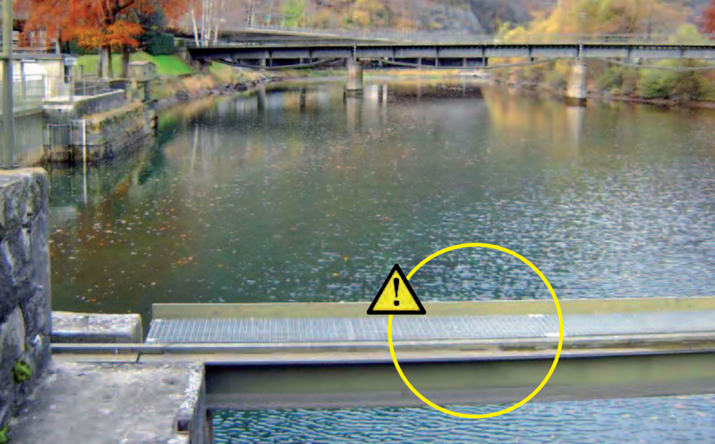
Fig. 8 - Strutture non concepite per l'accesso, prive di parapetti e altri provvedimenti di sicurezza.
