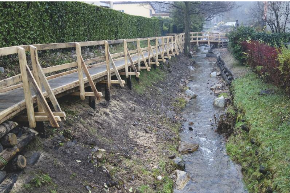
Il riale Rovagina a Ponte Capriasca dopo le recenti opere di sistemazione e rinaturazione, che hanno comportato fra l'altro la realizzazione di una passerella (foto di Mauro Marazzi).
