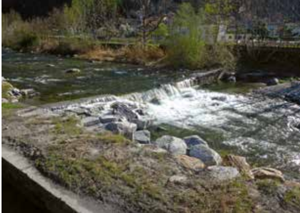
Il «salto» di Malvaglia prima dei lavori che hanno consentito di ripristinare la libera migrazione del pesce in questo tratto del fiume Brenno (foto di Tiziano Putelli).
