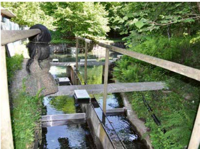
Due vasche con le griglie al pozzo di Arcegno.
