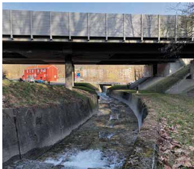
Finalmente hanno preso avvio i lavori di rinaturazione del riale di Gorduno (foto di Patrick Rusconi).
